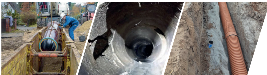
Foto 5: Colector de gres vitrificado
